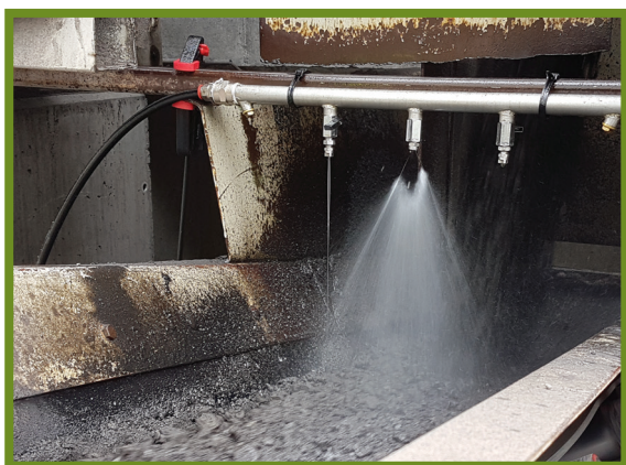
Figuur 4 – Toedienen van verjongingsmiddel aan AG op de aanvoerband door middel van een sproei-installatie (bron: OCW [21])
